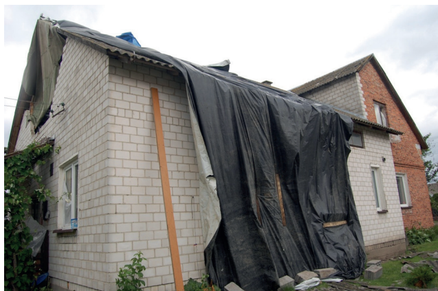
W ramach obowiązkowego ubezpieczenia budynków wchodzących w skład gospodarstwa rolnego należy się odszkodowanie m.in. za zerwany dach
