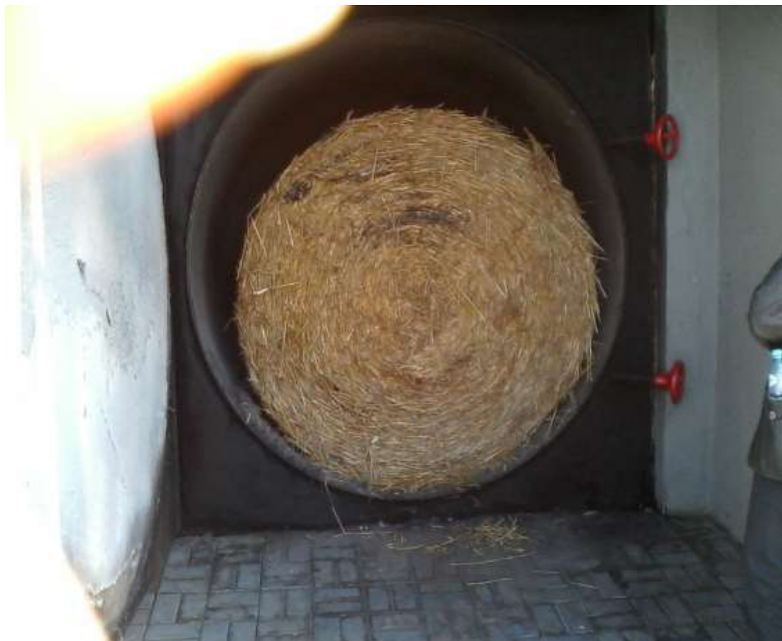
Fot. 1. Kocioł na baloty słomy SP Wierzchowo - gmina Człuchów
