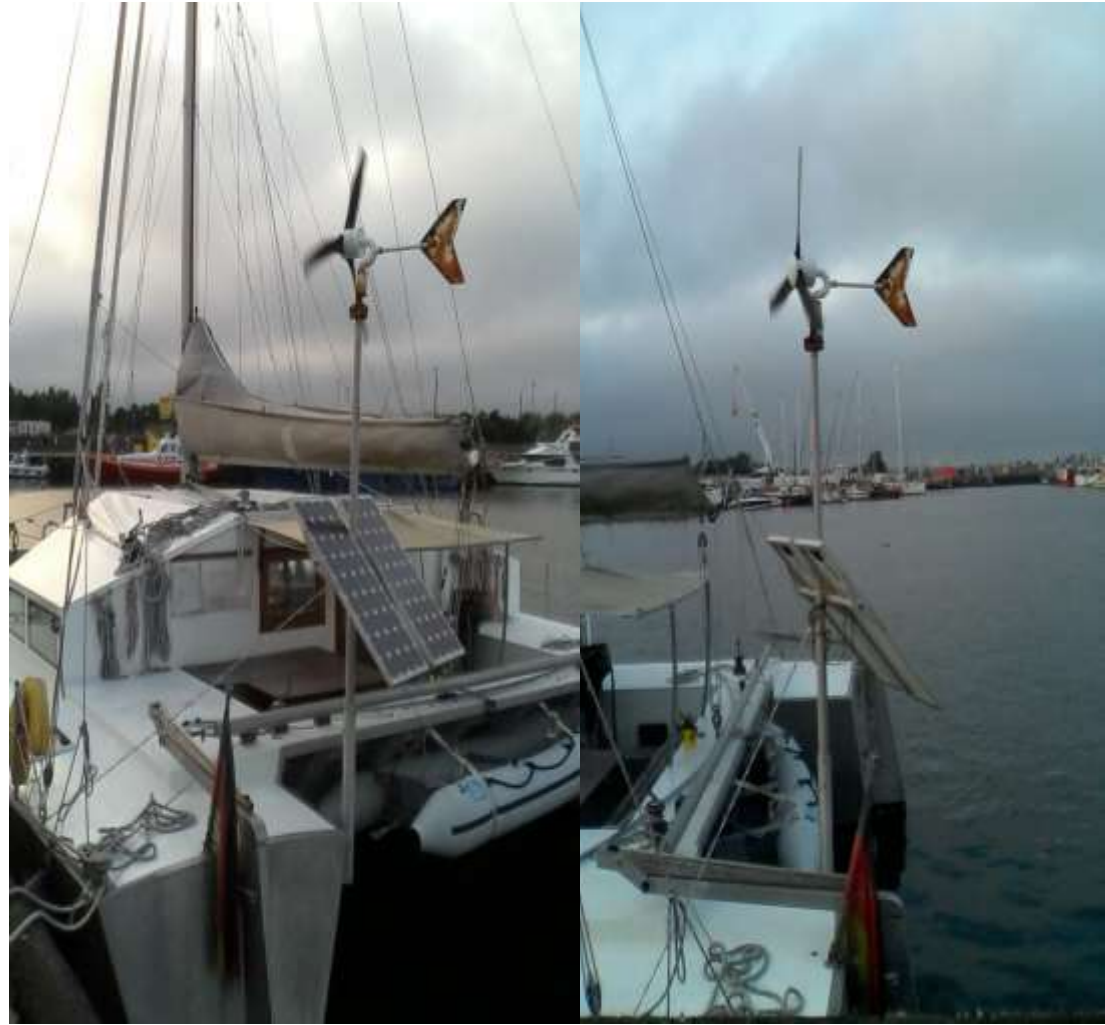
Fot. 6 Instalacja składająca się z turbiny wiatrowej oraz paneli fotowoltaicznych wspomagająca zasilanie katamaranu (gmina Władysławowo port Władysławowo woj. pomorskie)
