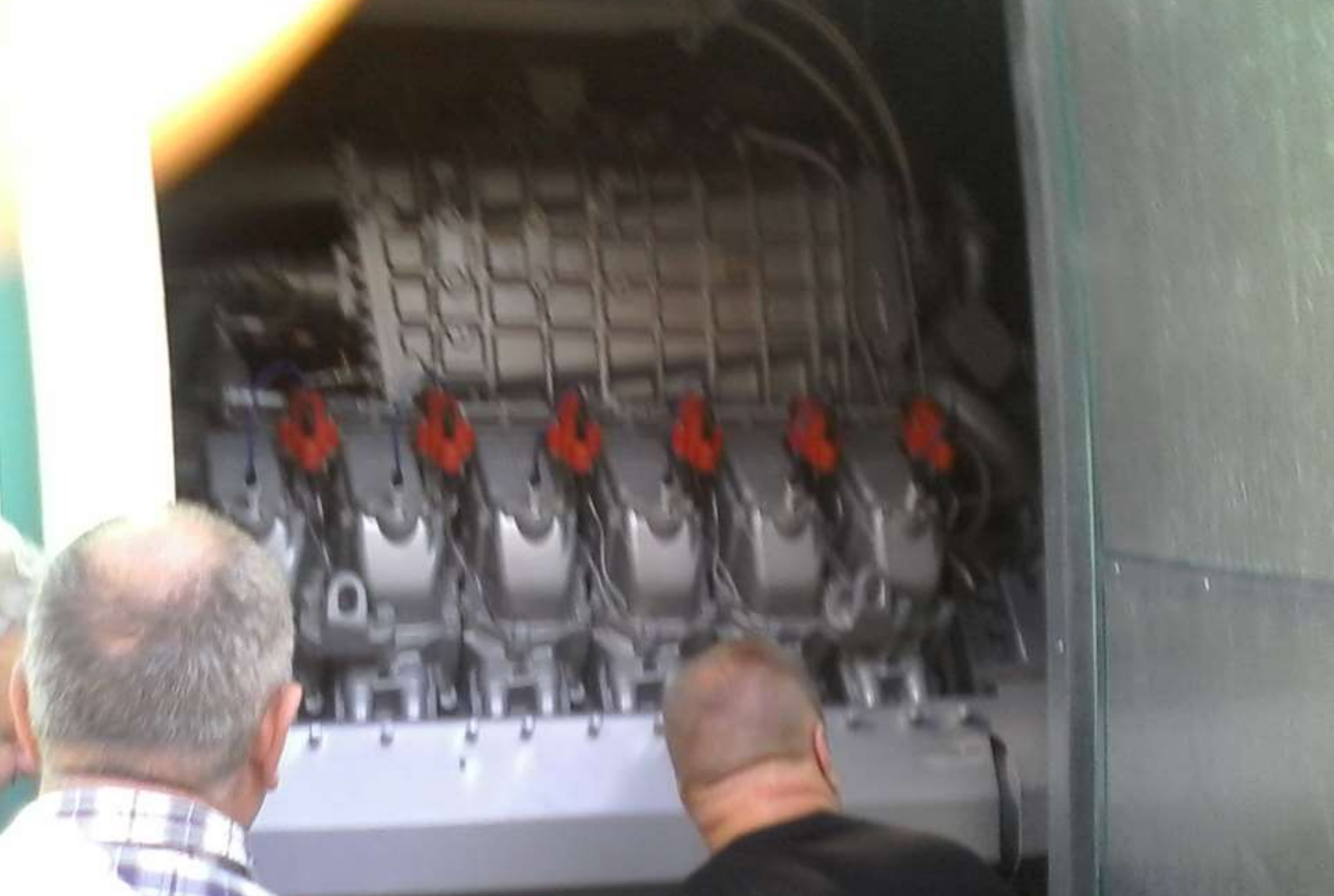
Wnętrze komory silnik kogeneracyjnego o mocy 1MW Gospodarstwo Rolne Biogaz T.S. Śmiechowcy Sp. z o.o. w Jaromierzu (gmina Człuchów)
