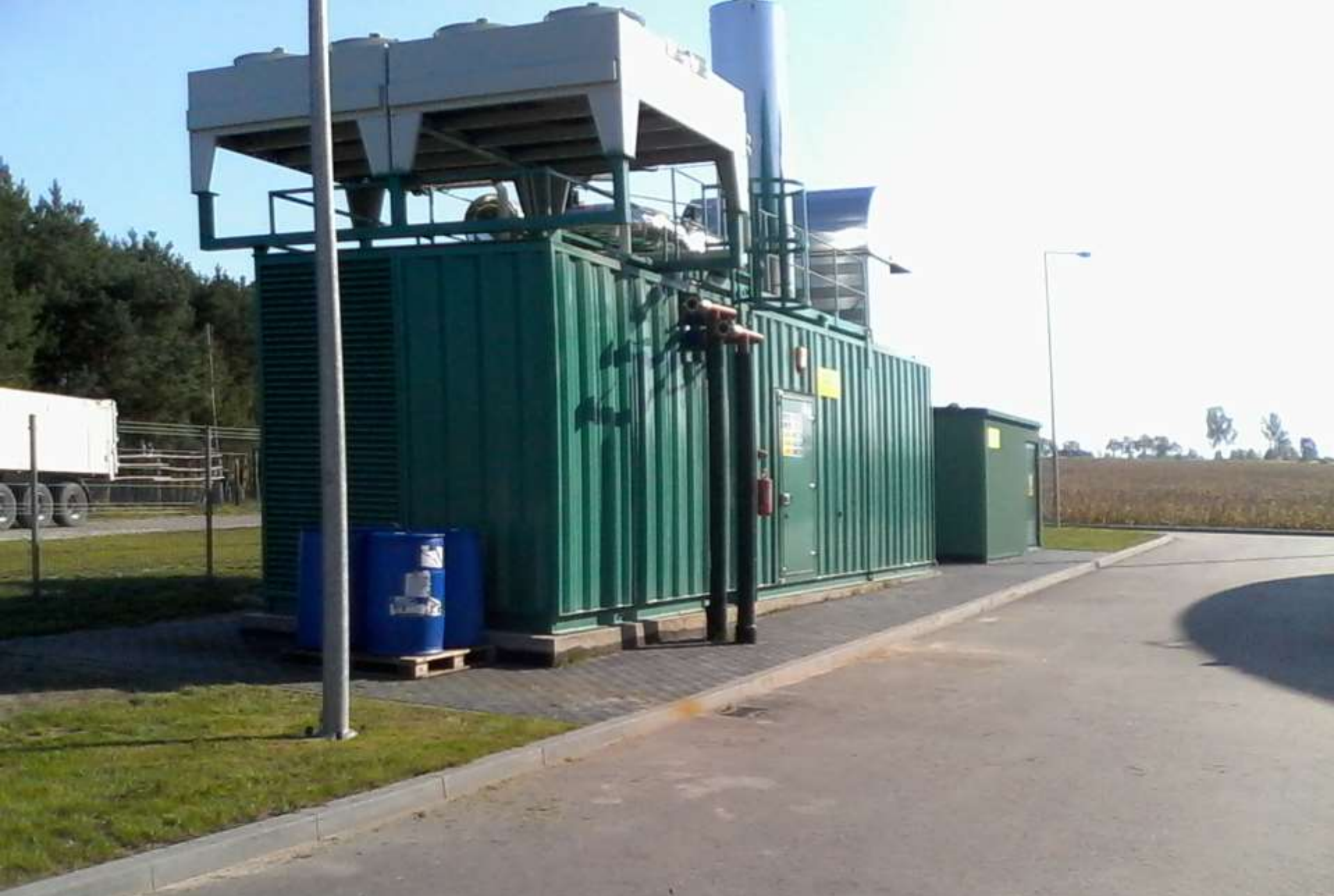
Silnik kogeneracyjny Gospodarstwo Rolne Biogaz T.S. Śmiechowcy Sp. z o.o. w Jaromierzu (gmina Człuchów)
