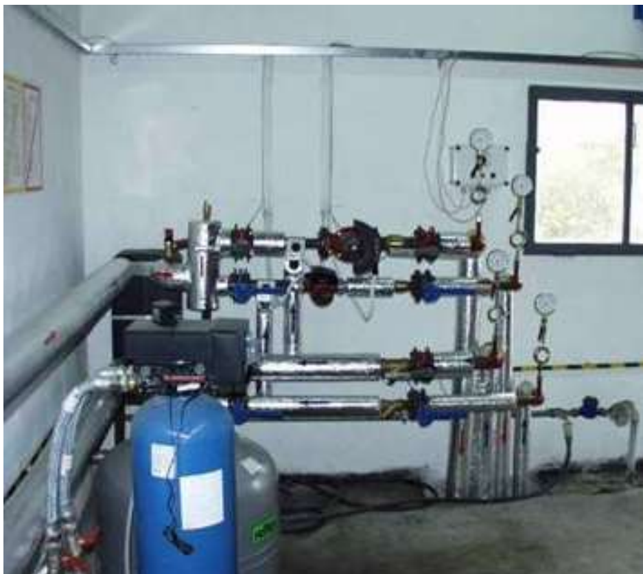
Fot. 2 Zawory oraz instalacja do regulacji temperatury wody SP Wierzchowo
